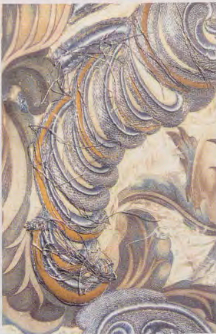
Detalle del deterioro de uno de los paños de la pared.
