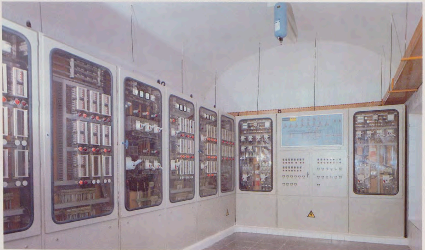
Desde este cuadro se controla todo el sistema eléctrico del Palacio.
