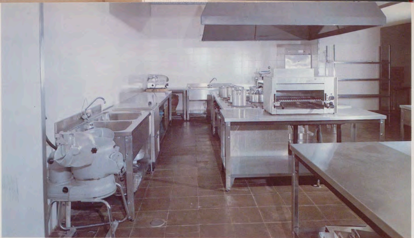
Las nuevas cocinas están situadas en los sótanos, inmediatas al Patio de los Borbones que será el nuevo comedor de gala.
