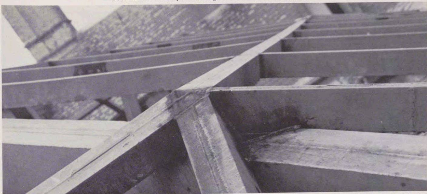
Detalle de la estructura portante octogonal sobre uno de los arcos diagonales.
