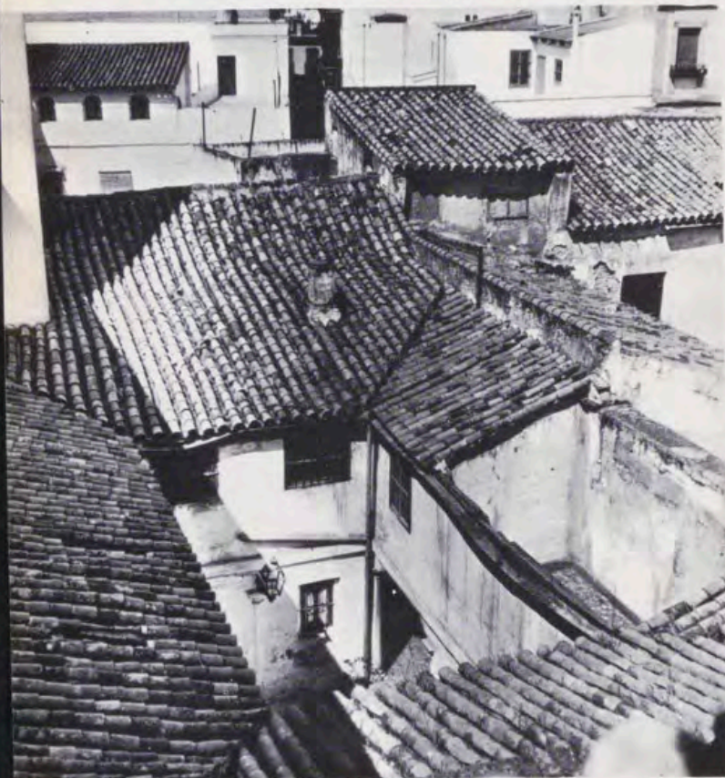
Tejados de las dependencias del Asistente, todos con sus estructuras lesionadas.
