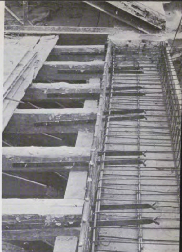
Organización constructiva de tirantes con formaletas colgadas, empotramiento en zuncho de hormigón y voladizo de cornisa. Al fondo, pares metálicos.
