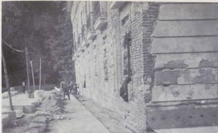
Antiguo abultado de yeso en el basamento, destrozado por las humedades.
