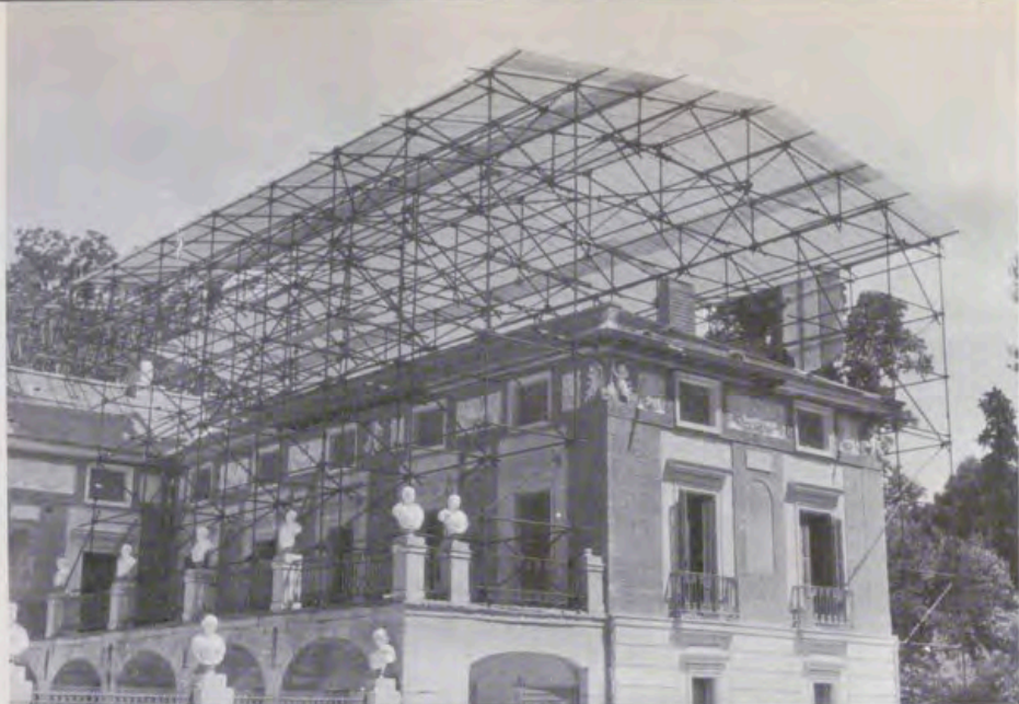
Llamativa sobrecubierta que, guarneciendo todo el edificio, permitió desmontar y rehacer las cubiertas sin peligro para el interior.
