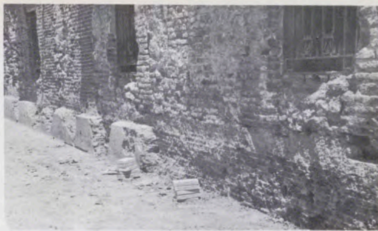
Tras de picar los abultados de yeso, se ve la disgregación de las fábricas.
